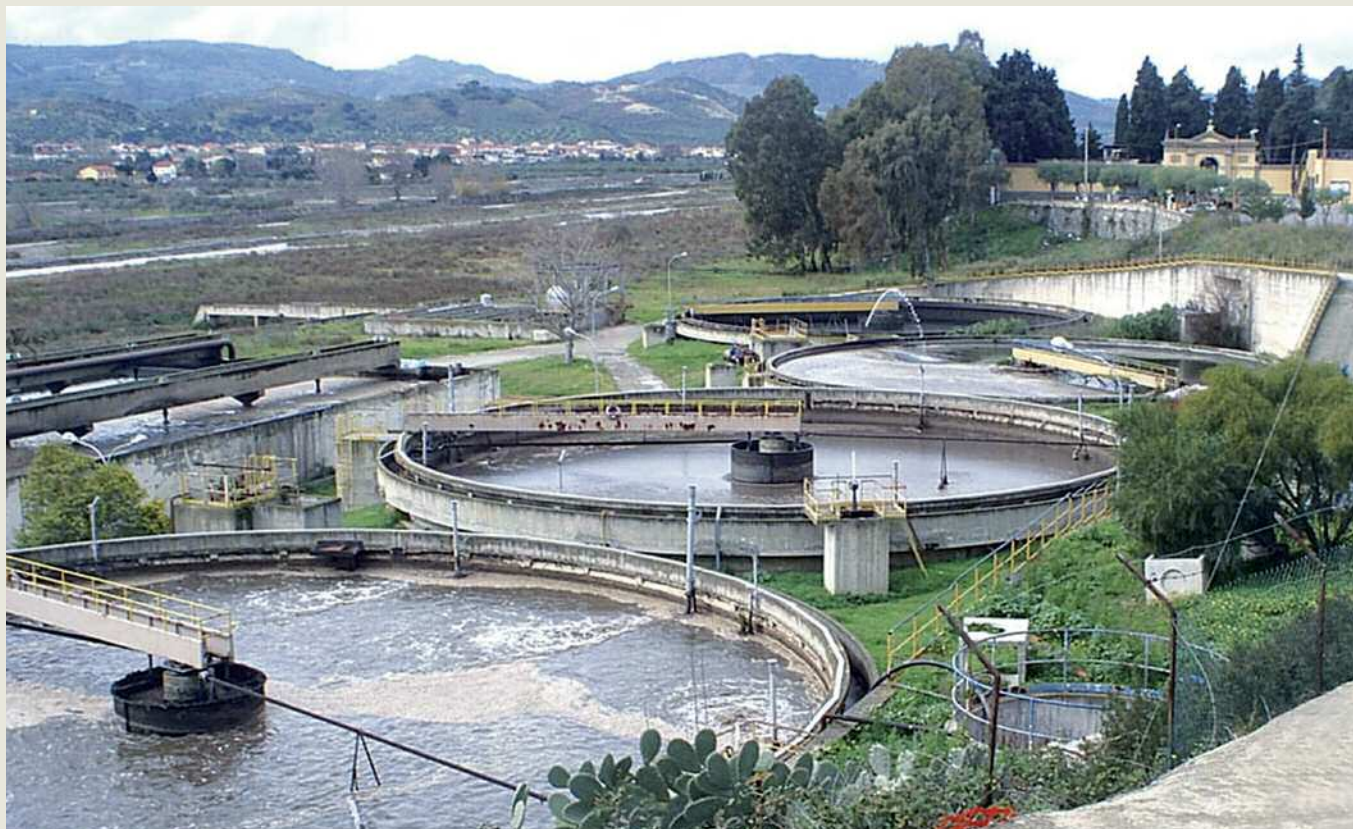
Fig. 1. Un impianto di depurazione delle acque reflue: vasche di trattamento aerobico delle acque.
